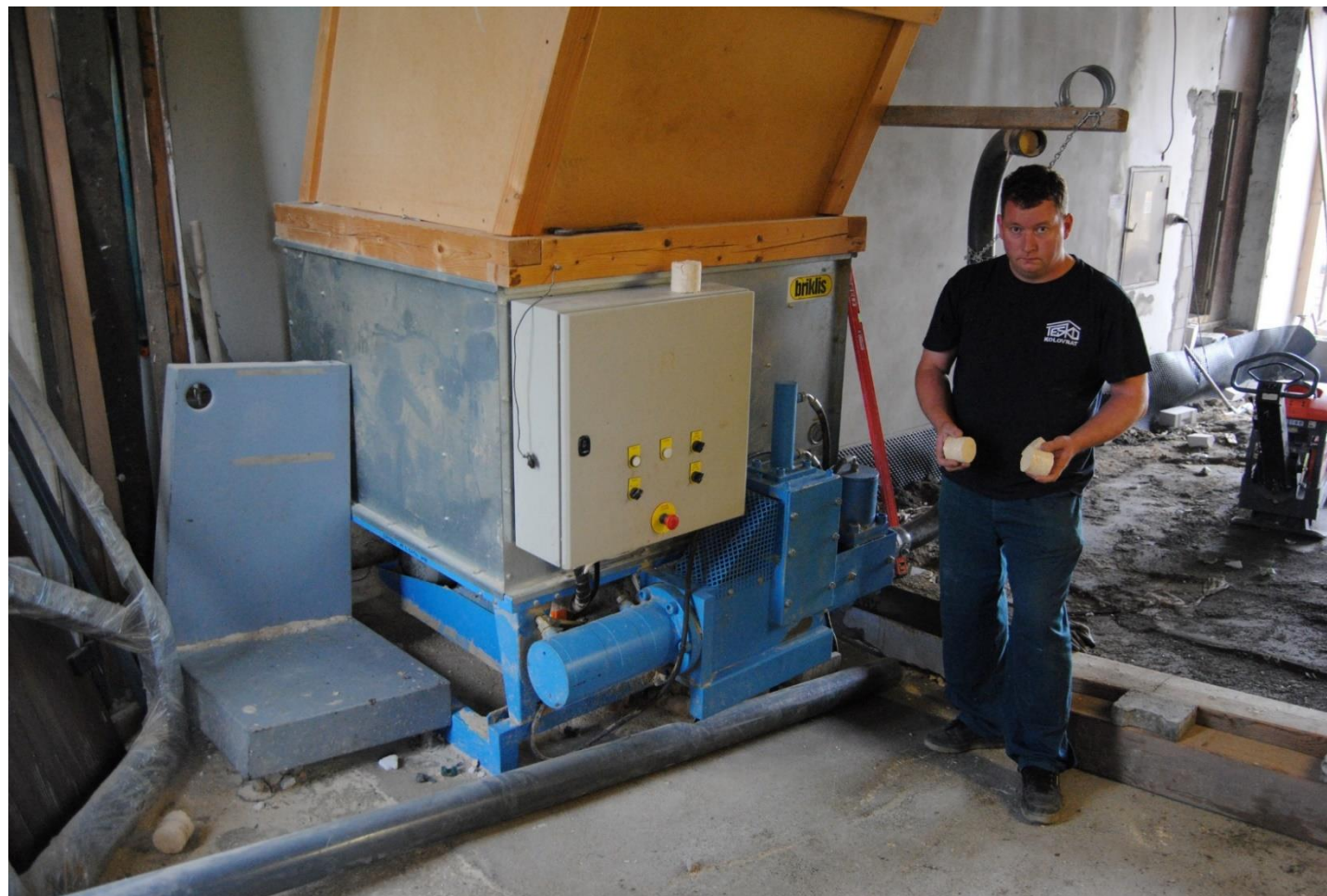
Firma Kolovrat – FVE a kotel na pelety
